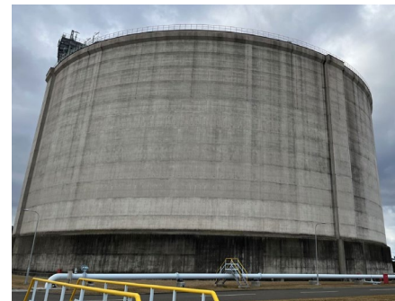
都市ガス事業者所有 LNG貯槽
