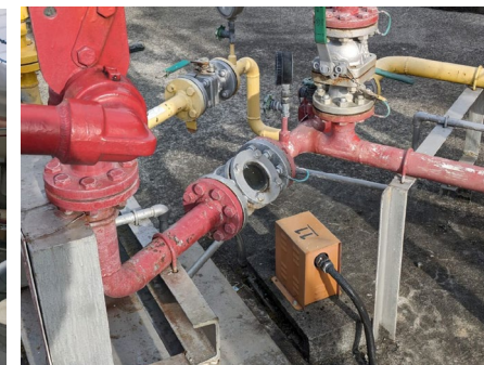
LPガス事業者所有 配管
