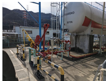
LPガス事業者所有 LPG貯槽
