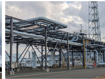
都市ガス事業者所有 配管ラック
