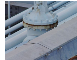
フランジの錆を撮影
