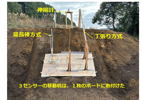
図6 盛土構造物における機器設置状況
