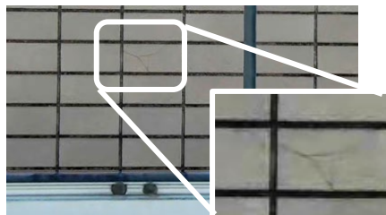
綜警神戸ビル6Fの軽微なひび割れ（ドローン映像）
